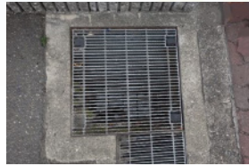
経年劣化したグレーチング
